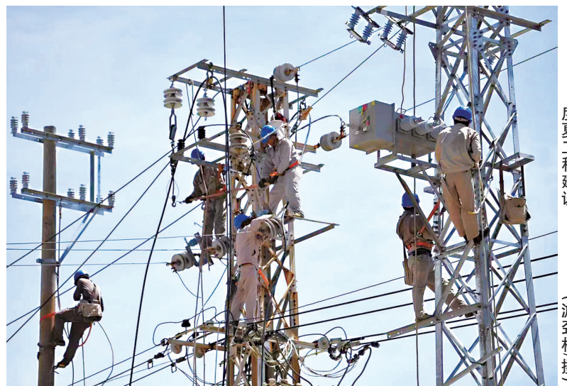
国网泉州供电公司全力推进迎峰度夏工程建设(游劲松摄)
