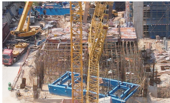
倒下的吊车动臂距离塔吊很近
