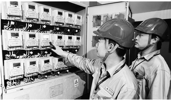
漳州供电公司工作人员检查自备电源 (陈慧/摄)
