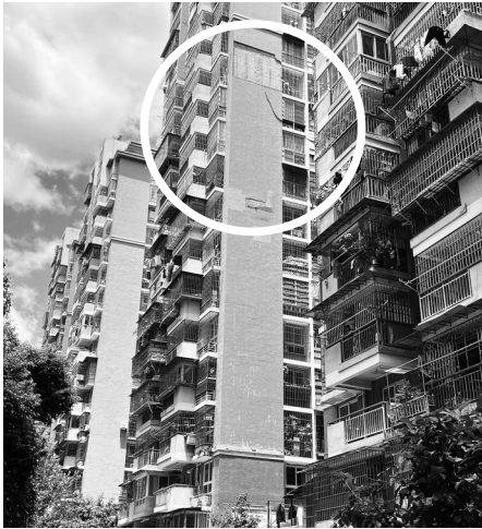
一片裸露出水泥墙面的区域位于居民楼十二层到十三层中间,约十平方米
