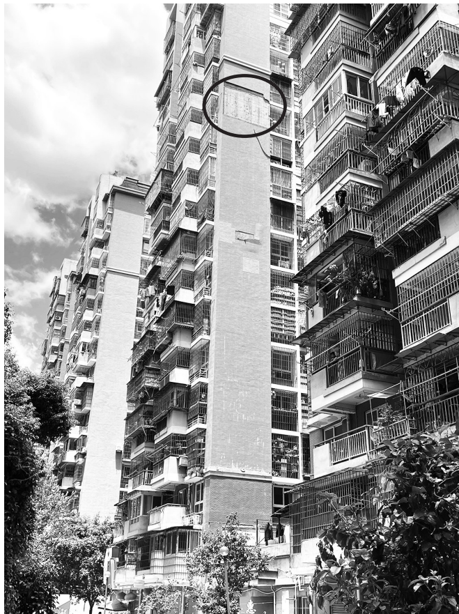
一片裸露出水泥墙面的区域位于居民楼十二层到十三层中间,目测有十平方米左右
