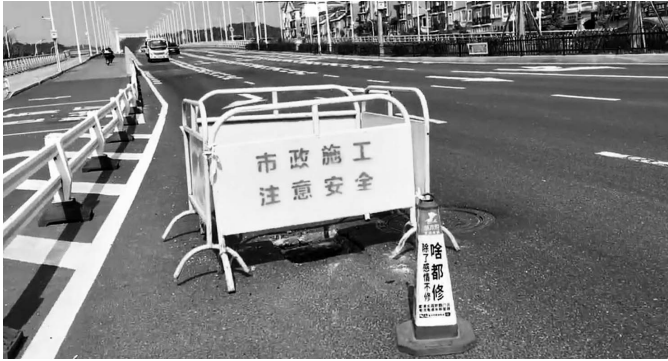
导致事故发生的雨水井已被围起
