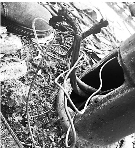
漏电路灯基座下电线多处被烧黑
