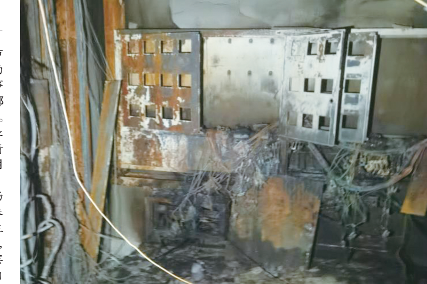
小区的电表箱已面目全非
