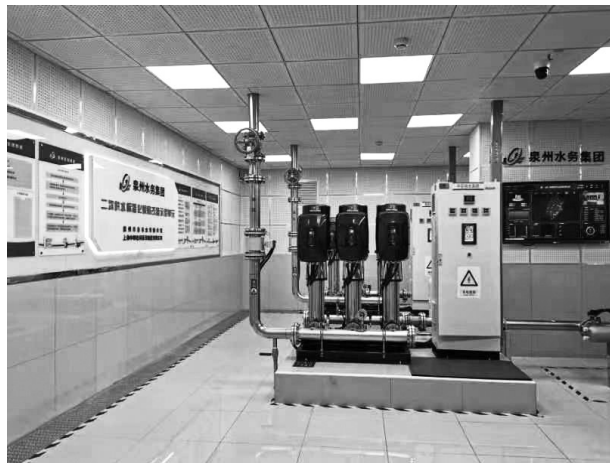
西湖豪庭小区改造后的二次供水设备(褚晶晶/摄)
