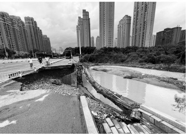
桥梁路堤及路面局部塌陷
