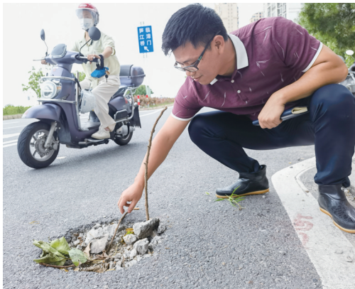
本报记者在破损处摆放枯枝,提醒路人注意避让
