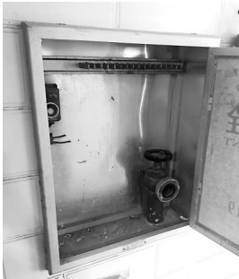
消火栓内设施缺失
