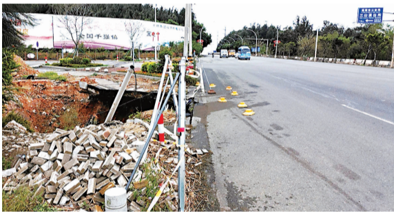
路基出现塌陷
