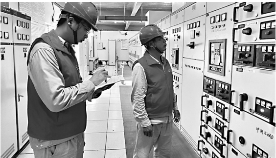
完成中国—菲律宾经贸创新发展示范园区建设推进会安保全供电工作
