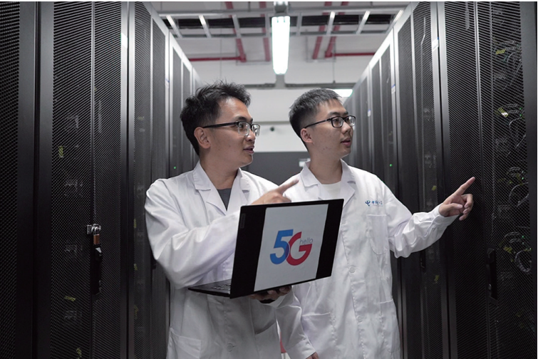
云数据中心机房巡检
