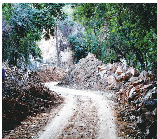
滑坡处已先清理出一条上山的道路
