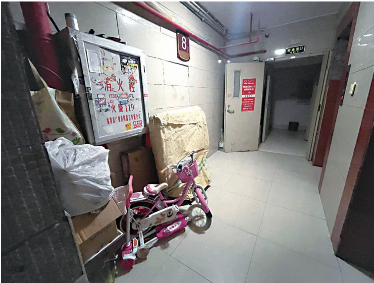
福州市台江区红星苑10号楼部分楼层的安全通道堆放杂物
