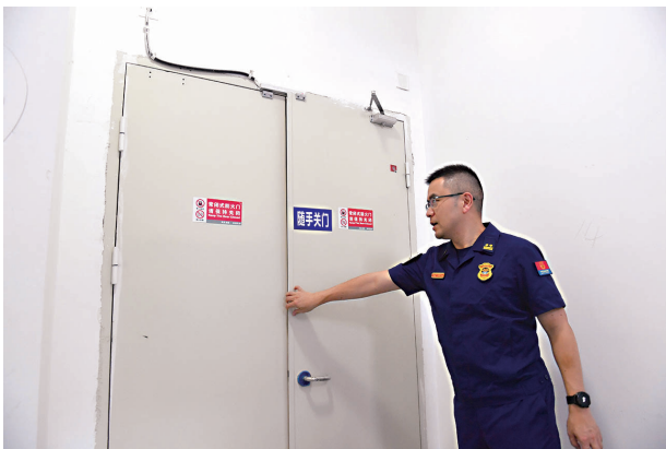
防火门应常闭不锁
