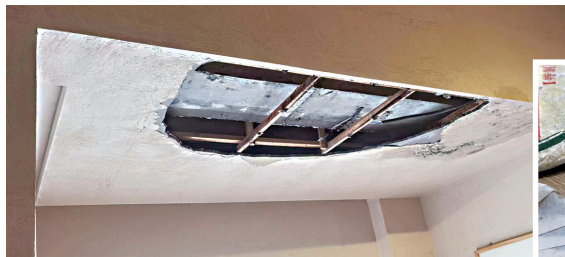
屋顶漏水,导致茶室天花板掉落
