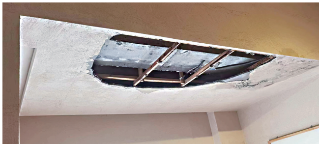
屋顶漏水,导致茶室天花板掉落
