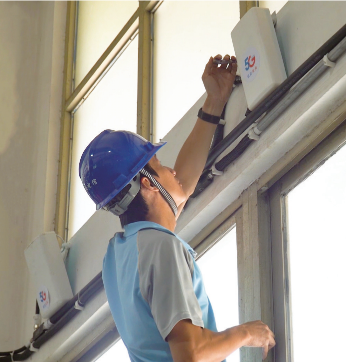
厂区 5G 室分设备调测
