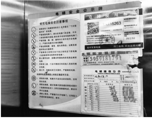
二十五日发生下坠情况的电梯刚进行过维护
