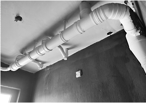
李先生家的卫生间管道被人私自更改了
