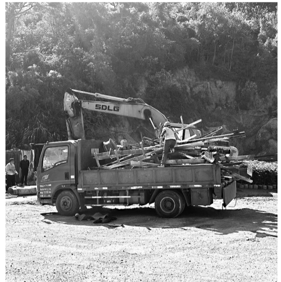
整治魁岐村魁岐山上阴厝笼乱堆放
