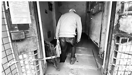
下陷处位于楼道口
