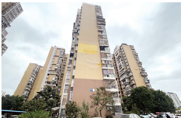
5号楼外墙修补后仍坑坑洼洼
