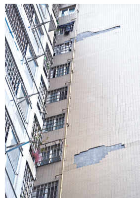
6号楼外墙瓷砖脱落
