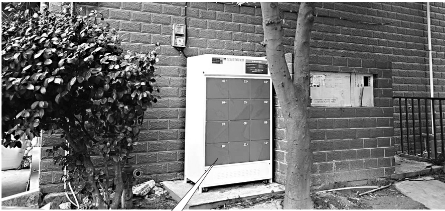
晋安区中辉新苑小区里,安装了两轮电动车换电站
