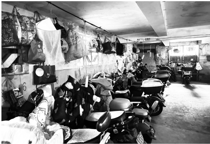
凤凰新村的一处充电区,采用的不是智能充电桩,而是牵出数根插排,并挂在电动车上方供使用
