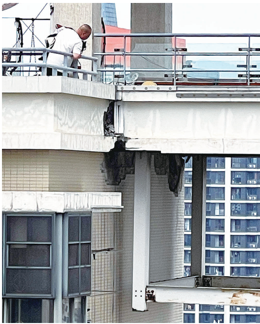
业主在露台查看空中天桥被震裂的位置
