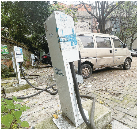
华屏路上一充电站未见灭火器,且离居民楼过近
