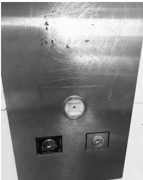
电梯的控制按钮已掉落
