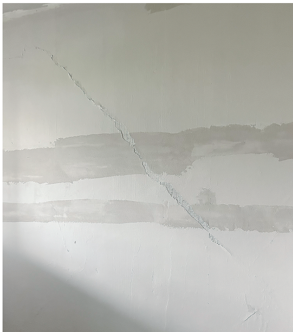
业主家中次卧位置处的墙体有一道明显裂纹
