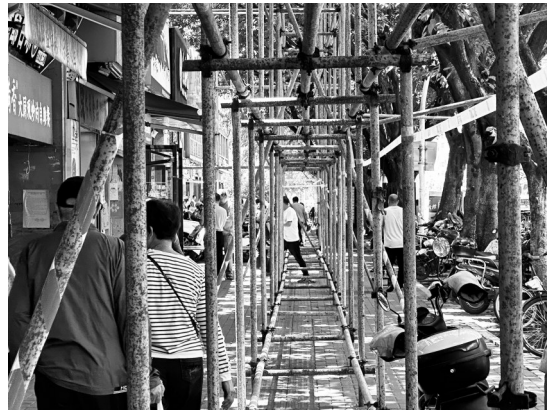
行人需要跨越脚手架才能进店
