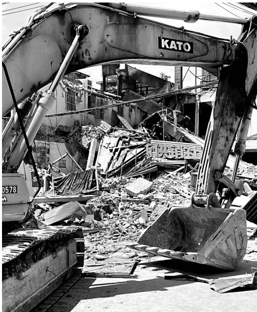
房屋倒塌现场
