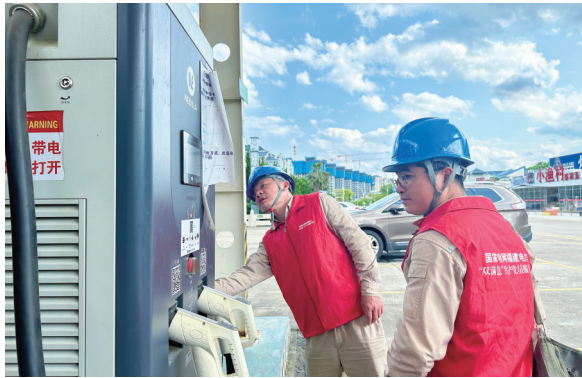
5月10日,亿力集团所属龙岩瑞源公司工作人员对客家剧院充电桩设施进行检查
