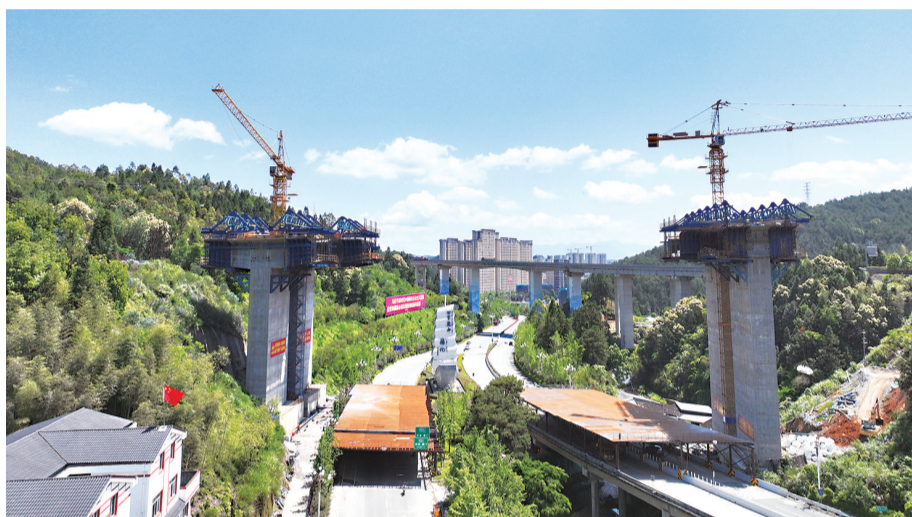
德化县城区大外环路盖德至英山段(含大坂连接线)项目火热施工中
