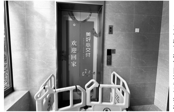
九号楼西梯前围有黄色护栏
