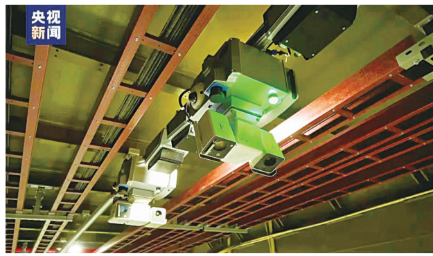
智能巡检机器人
