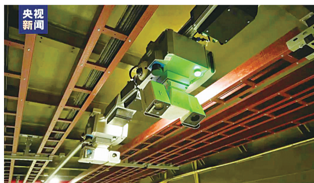
智能巡检机器人
