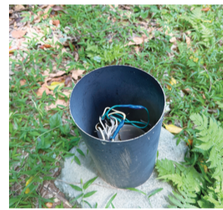
破损的灯座不仅边缘锋利,里面还有多根电线
