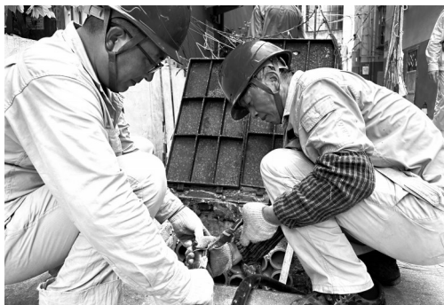
7月11日,莆田荔源集团工程公司施工人员在英龙社区进行电缆敷设和导线更新改造
