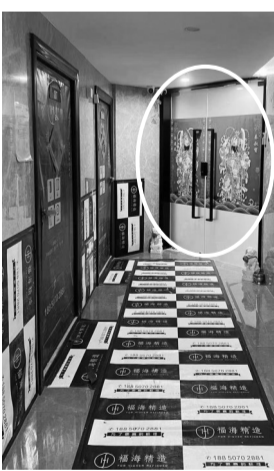
此前,消防通道被私装玻璃门(画圈处)隔断
