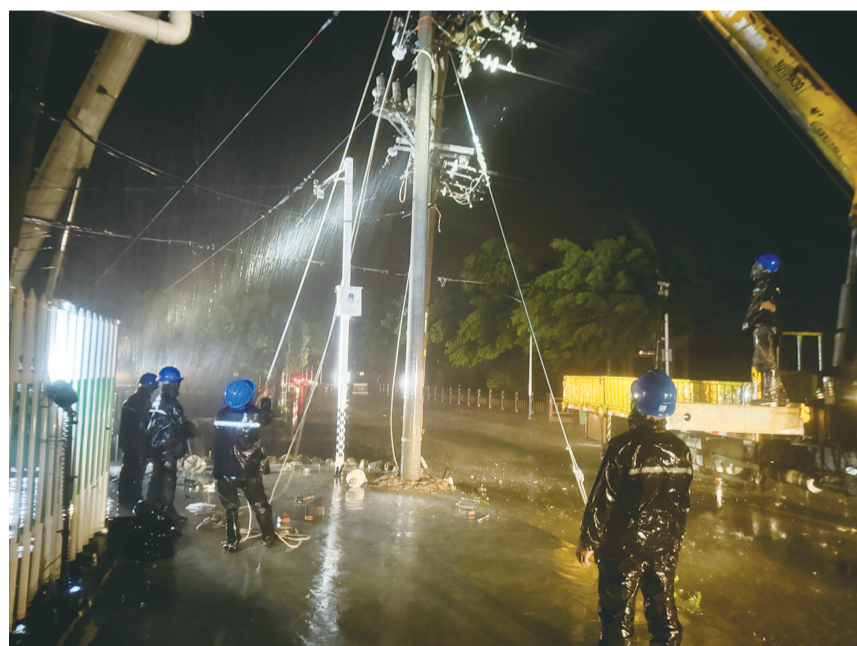
7月25日,国网三明供电公司跨区支援抢修队伍在抢修福州连江10千伏道澳线路
