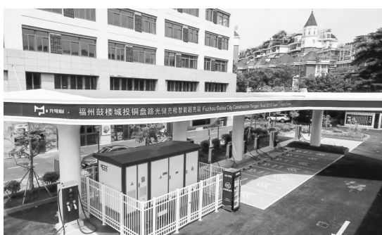
鼓楼城投铜盘路光储充检超级充电站
