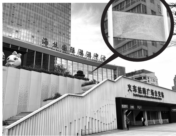
大楼4楼一块玻璃破裂
