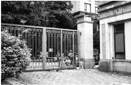
已设置警戒线 小区大门石材脱落，现场
