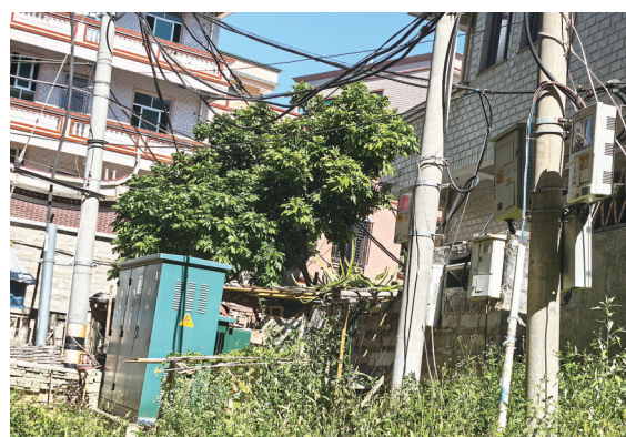
村民的临时用电就是这个变电站接入的
