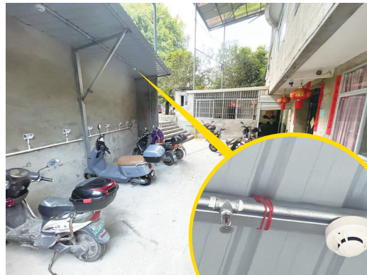
了喷淋装置、报警器等 建新镇涉案的自建房,增设
