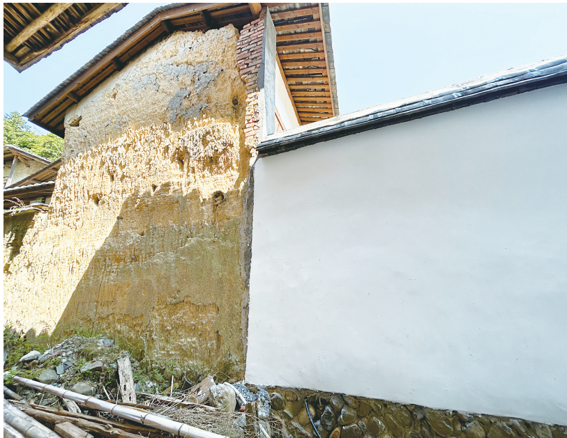
前半段已修缮的防火墙和后半段未修缮的危墙形成鲜明对比
