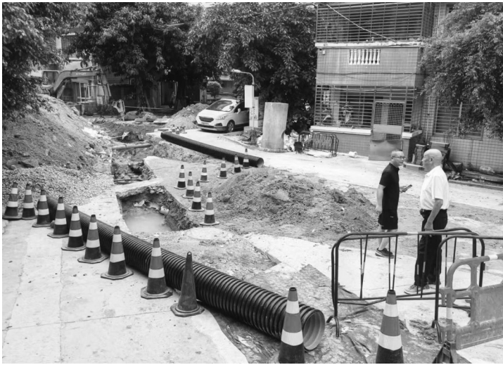
12幢楼下挖出一条深坑,现场未围挡,仅放置一排警示锥
