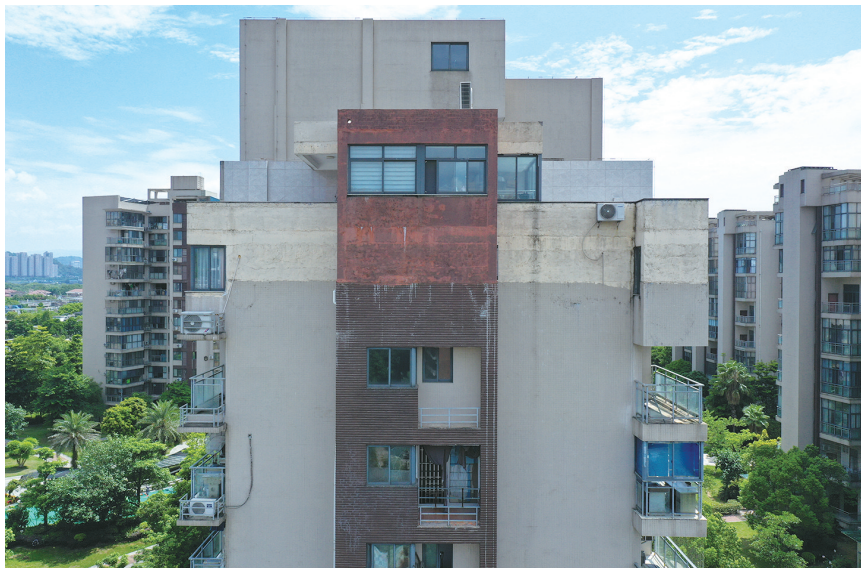
10号楼顶楼违建
