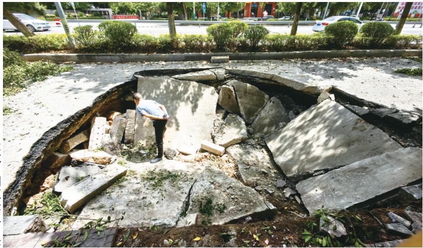
大坑目测直径超四米
